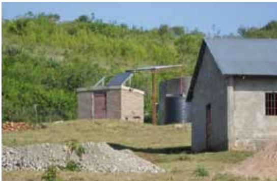
Die neue Trinkwasserreinigungsanlage im kenianischen Dorf Tonga wird mit Solarenergie betrieben.
