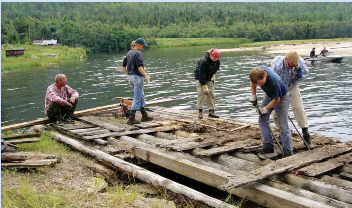
Nature Summer Camp-Teilnehmer bei der Arbeit an einem alten Bootsanlegesteg am Baikalsee in Russland
